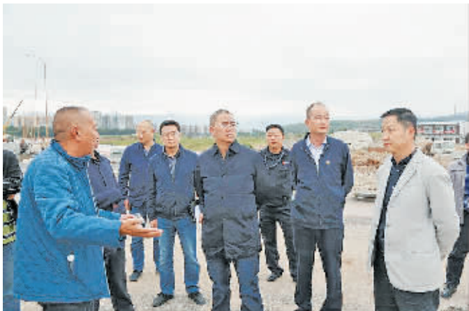
李俊深入城区部分在建工地，专题调研城市道路交通等基础设施建设。
